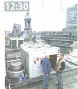
Der Leiter der Haustechnik, Winfried Baldegweg (re.) kontrolliert mit Klimatechniker Bernd Reuschel (li.) eine Anlage auf dem Dach des Theaterhauses
